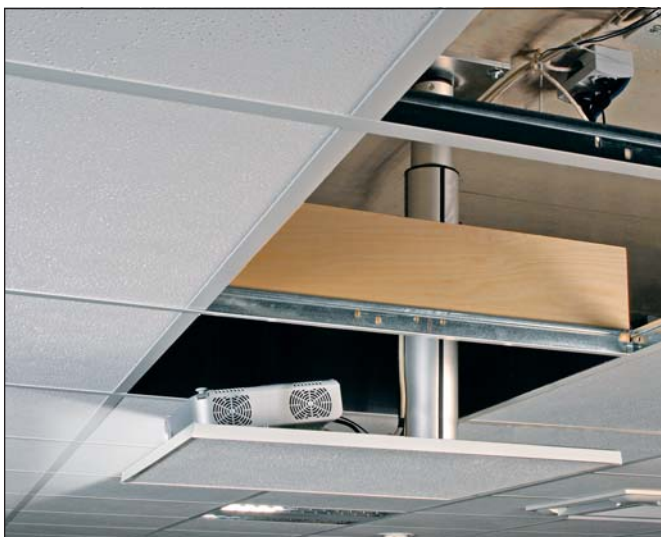
In der Deckenverkleidung eingelassener Beamer. Höhenverstellung über RKSlimlift -Hubsäule. Concealed beamer in suspended ceiling. Height adjustment using an RKSlimlift lifting device.
